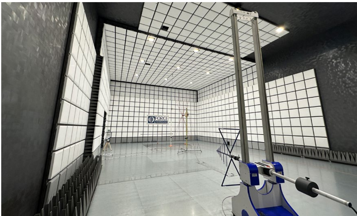
MÄTNING AV UTSTRÅLADE EMISSIONER HOS DELTA (FORCE TECHNOLOGY) I VÄSTERÅS. KÄLLA: DELTA I VÄSTERÅS
